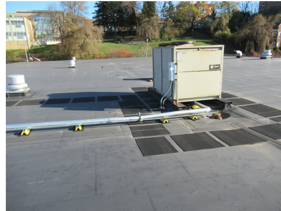
6 PHOTO 5 - EXISTING MECH EQUIP SCALE: N.T.S.
